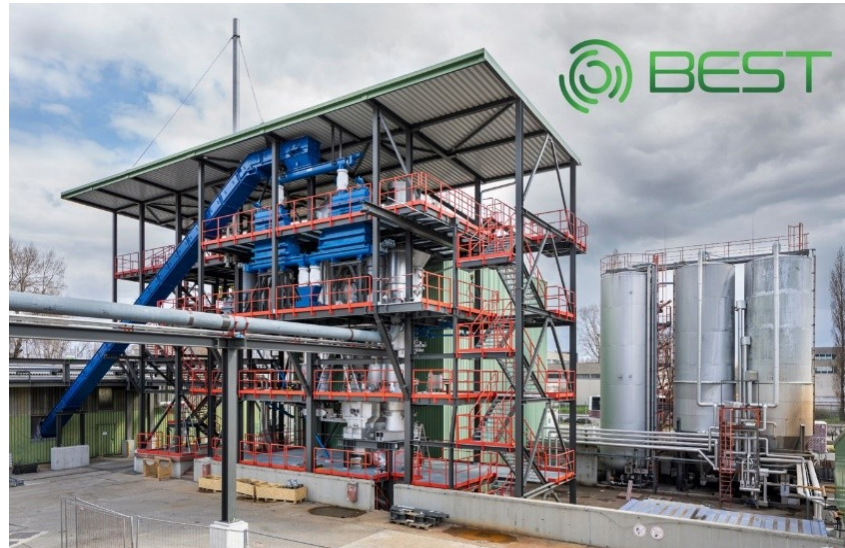
1 MW DFB Gaserzeuger der Syngas Plattform Wien
