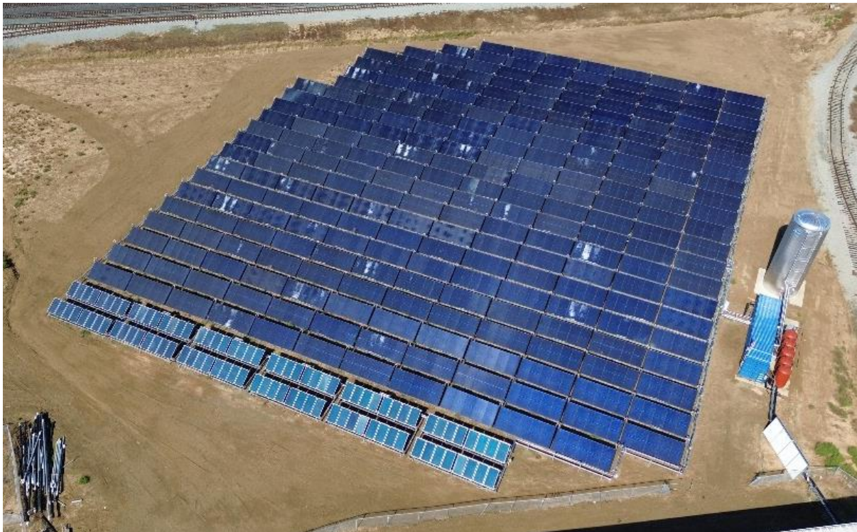
Abbildung 5: Implementierte Solarthermieanlage, Wärmespeicher (rechts im Bild), und Solar-Container (südlich des Speichers).
