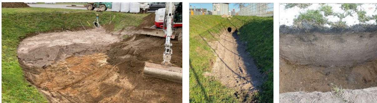
Abbildung 3: Sanierung von MZ (links) und ML (Mitte) mit technischem Filtersand und Bodenprofil von ML (rechts, 2 m vom Zulauf) nach 3 Betriebsjahren.
