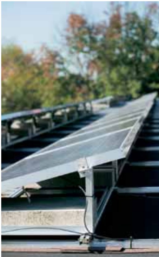
Das System besteht aus 262 polykristallinen 158-SP PV-Modulen von Schüco
