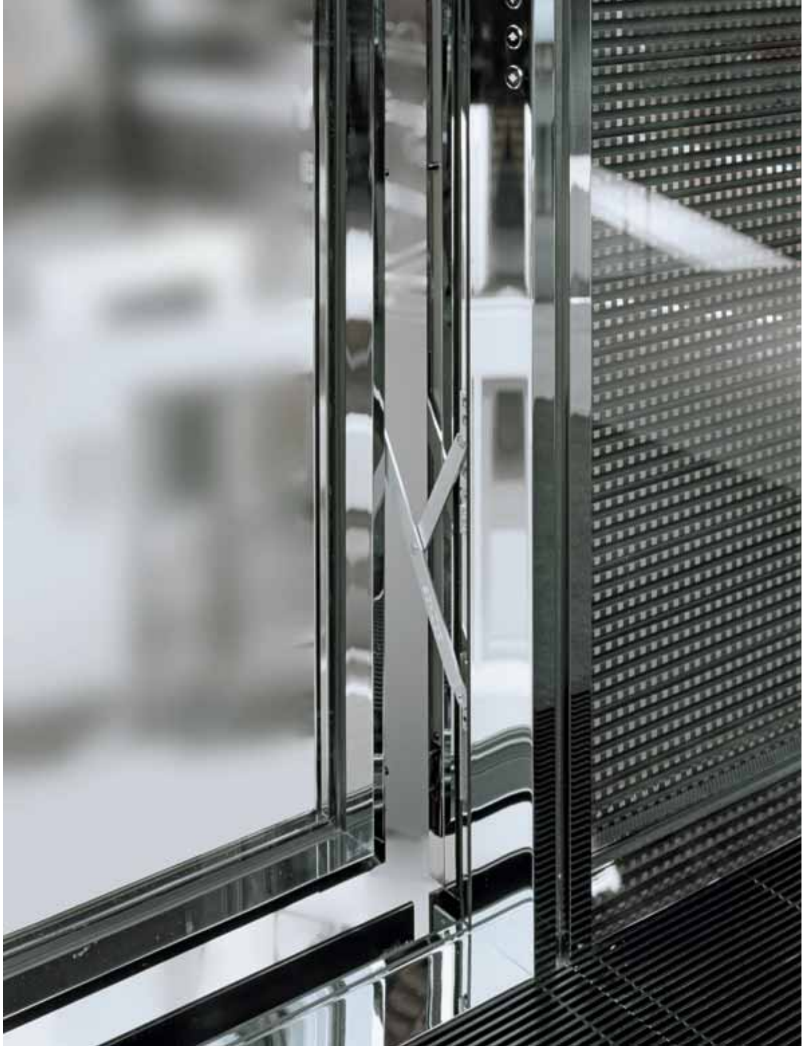
Vollautomatisierung der Fassade Full automation of the façade
