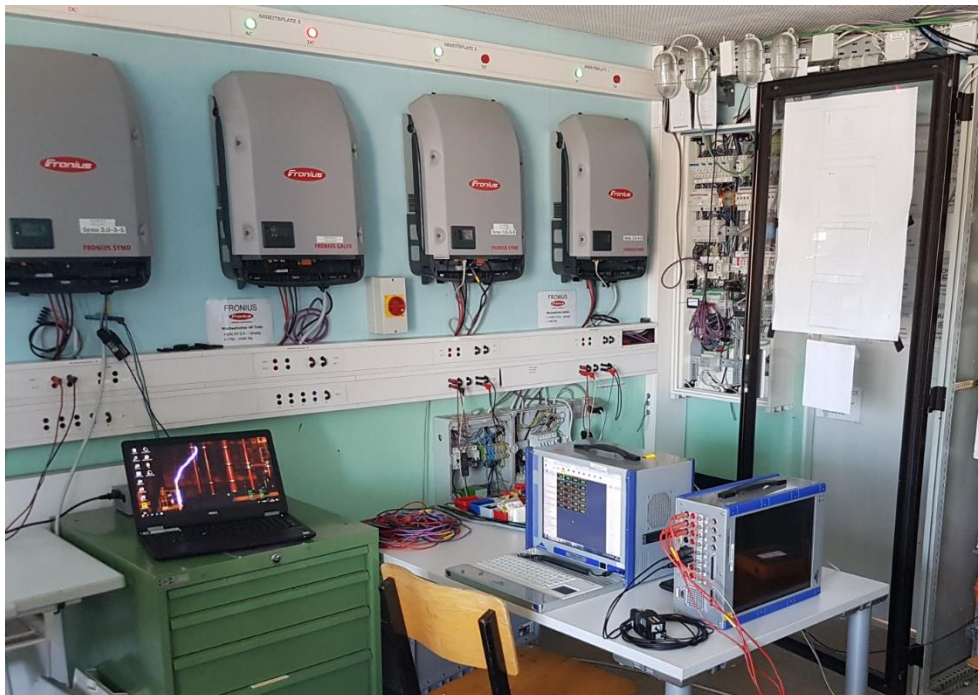
Abbildung 30: Teil des Mess-Setups im Inneren des Solar-Containers und Messpunkte für die drei Anlagenmesspunkte, sowie Wechselrichter PV-Anlagen EZA-1, E EZA-2 und E EZA-3.
