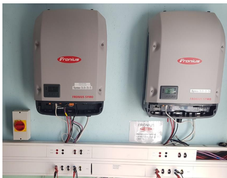
Abbildung 23: Zwei Wechselrichter im Innenraum des Solar Containers (diese wurden u.a. auf für die Messungen herangezogen)
