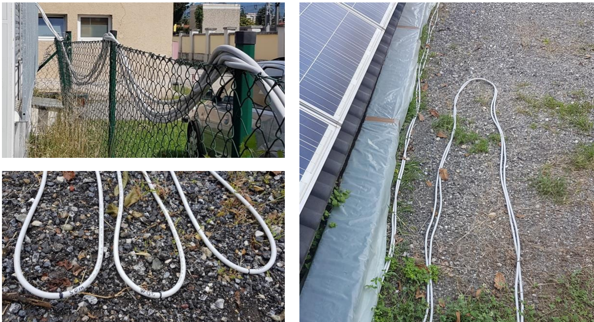
Abbildung 26: Rudimentäre Leitungsverlegung der Anlagenzuleitungen am Gelände des Green Village
