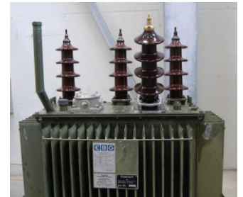
Abb. 1: Umgebauter Transformator am IEAN
