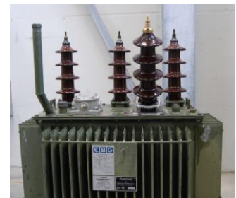
Abb. 1: Umgebauter Transformator am IEAN
