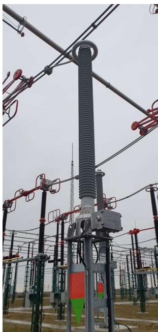
Abbildung 4: RC Teiler 400kV, Pfiffner
