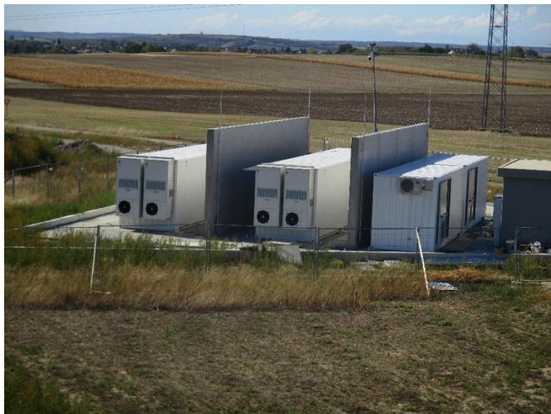
Batteriecontainer, Steuerungscontainer, Trafostation
