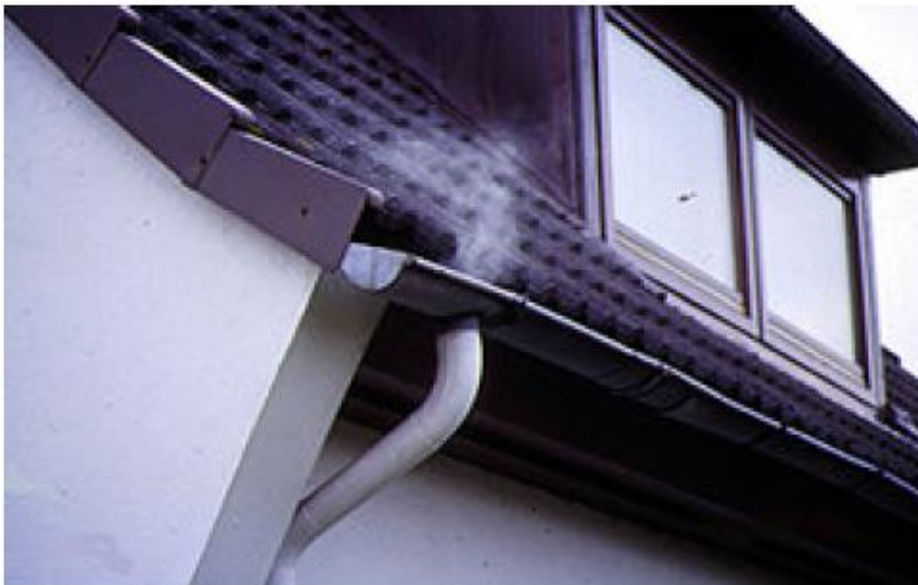
Abbildung 30: Rauchaustritt bei Dacheinläufen (Scaria, 2002)
