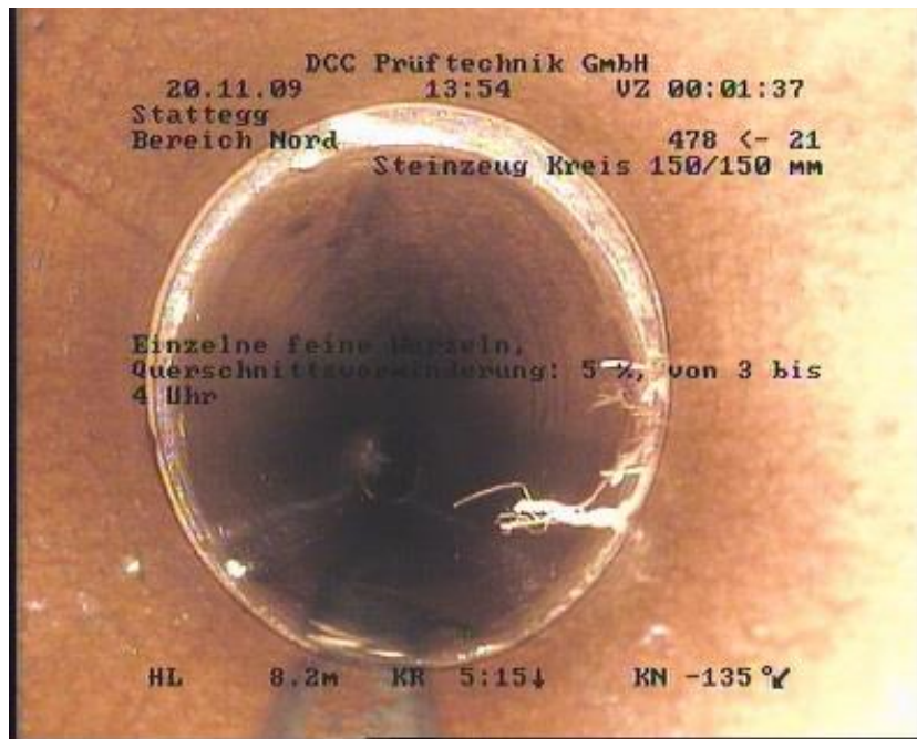
Abbildung 59: Wurzeleinwuchs (eigene Untersuchungen Gemeinde Stattegg, 2009)
