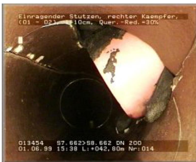
Abbildung 6: Fehlerhaft angeschlossene Zuleitung (Environment Consult in Scaria, 2002)
