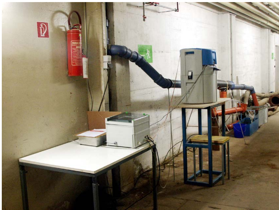
Abb. 5.6 Probenahme-Anlage mit Memograph und Probenehmer
