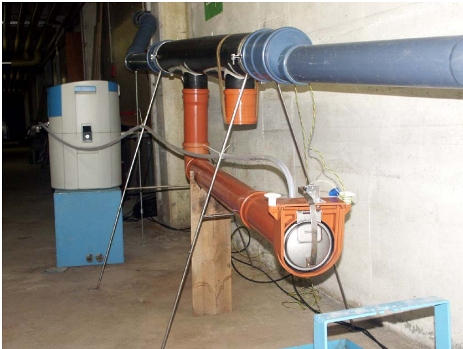
Abb. 5.7 Rückschlagklappe und Probenehmer
