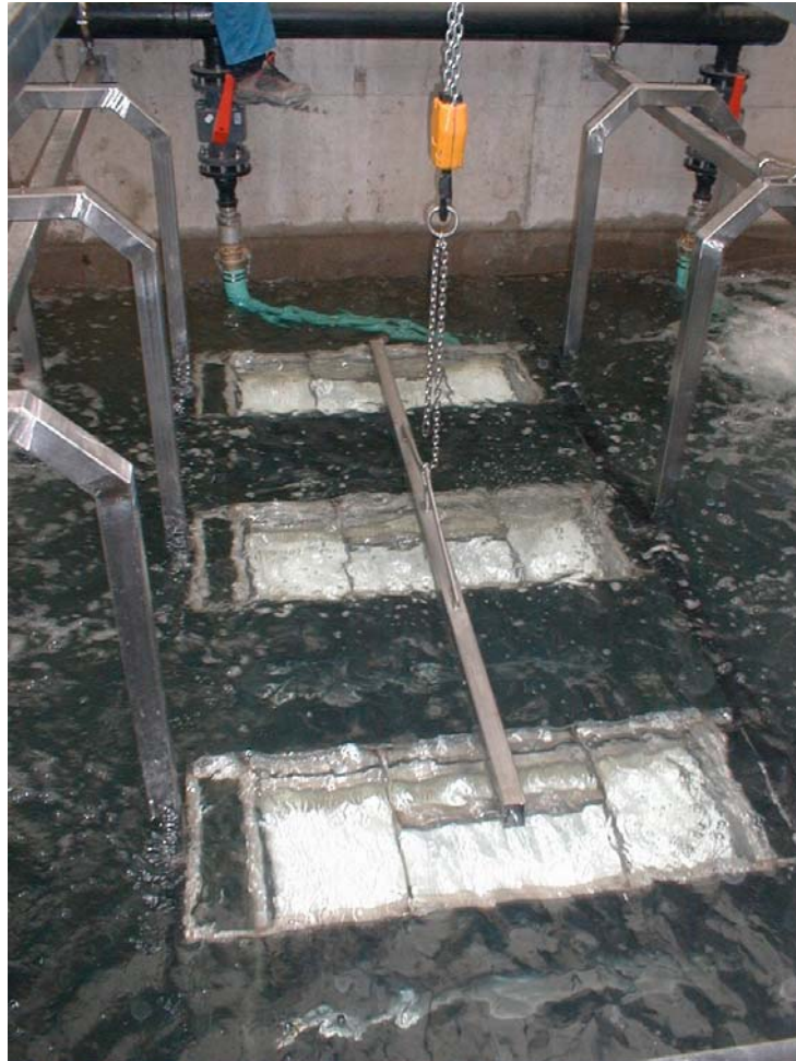
Abbildung 7: Membranmodule im Reinwasser
