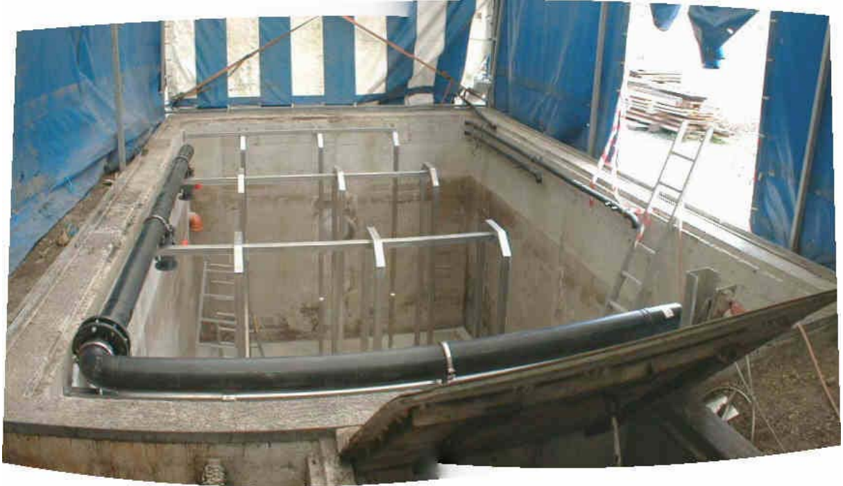
Abbildung 6: Nitrifikationsbecken mit Stahlkonstruktion für Membranmodule
