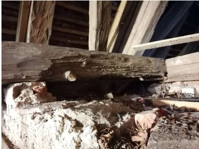
Abbildung 17: Pilzbefall am Wechselbalken
