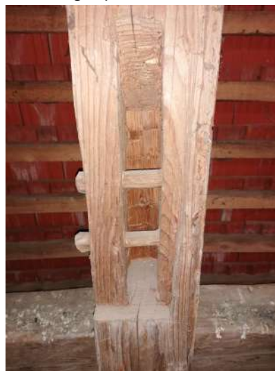
Abbildung 10 Zapfenloch in Stuhlsäule von fehlendem Kopfband
