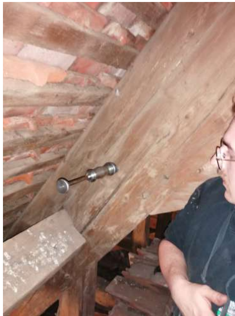
Abbildung 7: eingeschlagene Elektrode für Holzfeuchtemessung
