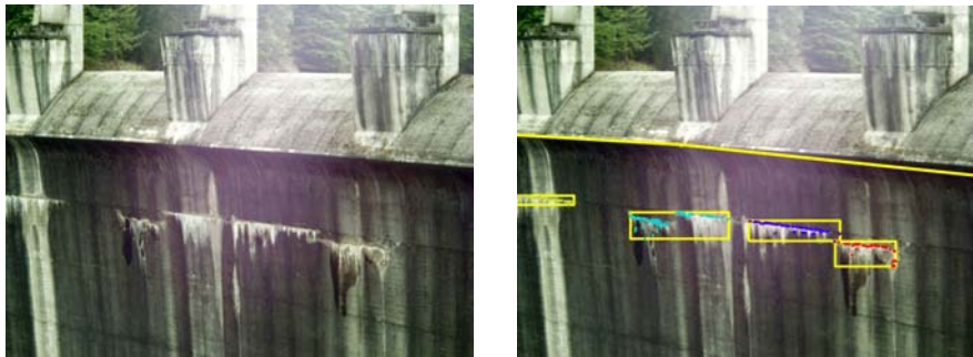
Abb. 7: Originalfoto aufgenommen mit der Überblickskamera von der Sperre Hierzmann (links), dasselbe Foto überlagert mit den Ergebnissen der Schadstellendetektion und der definierten Mauerumrisslinie (rechts)
