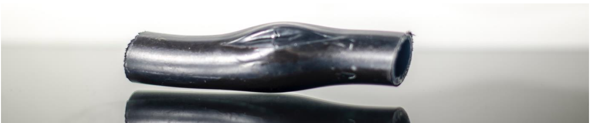
Abbildung 153: Durch gefrorenes Wasser geplatzte Wasserleitung
