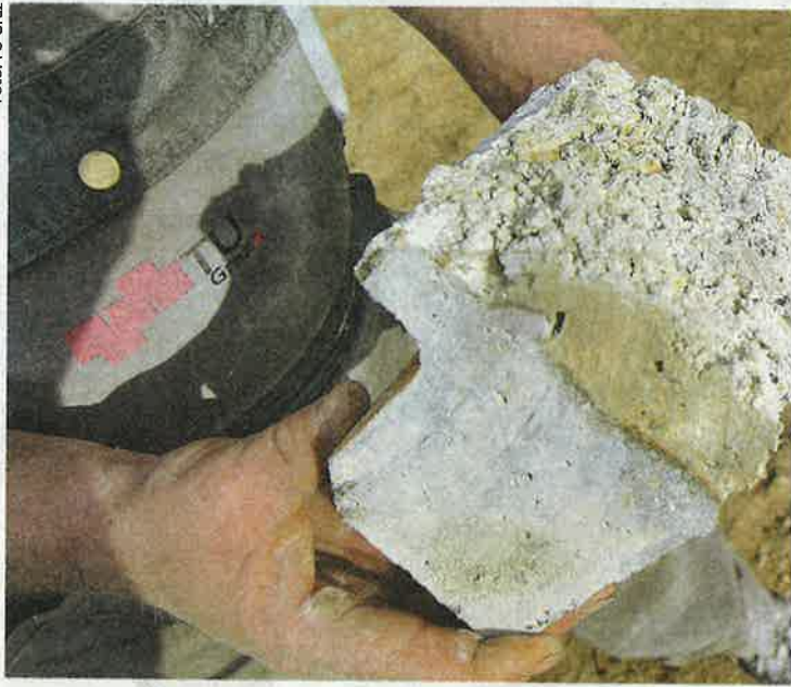
Schwefelsäure-Korrosion schädigt Kanal- und Abwassersysteme, verursacht Kosten und ist gesundheitsgefährdend.
