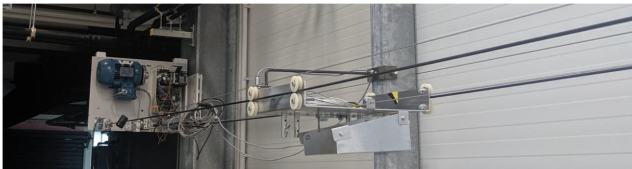
Bild 4: Impression zum installierten Messschlitten
