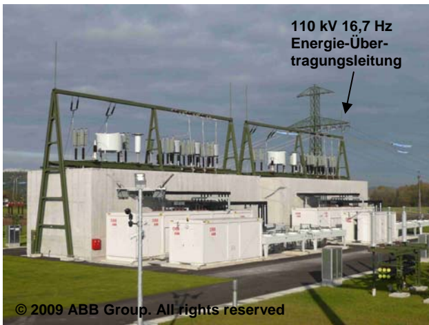
ÖBB-Umrichterwerk Timelkam, 30 + 30 MW, Außenansicht auf Umrichter-Container, Kühlanlage, Trafo-Einhausungen
