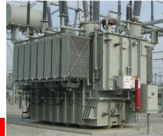
Transformator mit Monitoringsystem
