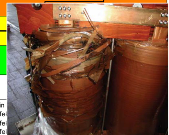
weiterer Betrieb resultiert möglicherweise in einem Fehler! — B1 Windungsfehler eines Transformators
