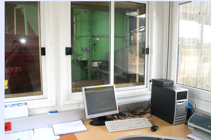
Programmsteuerung - KD - Trockner
