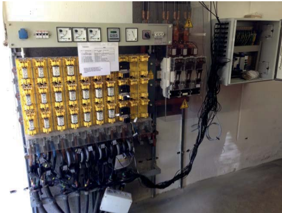
Abbildung 4: Installierte Messtechnik in den Ortsnetzstationen – Messung mittels Kabelumbauwandlern im Zugang der Niederspannungshauptverteilung und an den einzelnen Abgängen sowie Kommunikationsanbindung (rechts)
