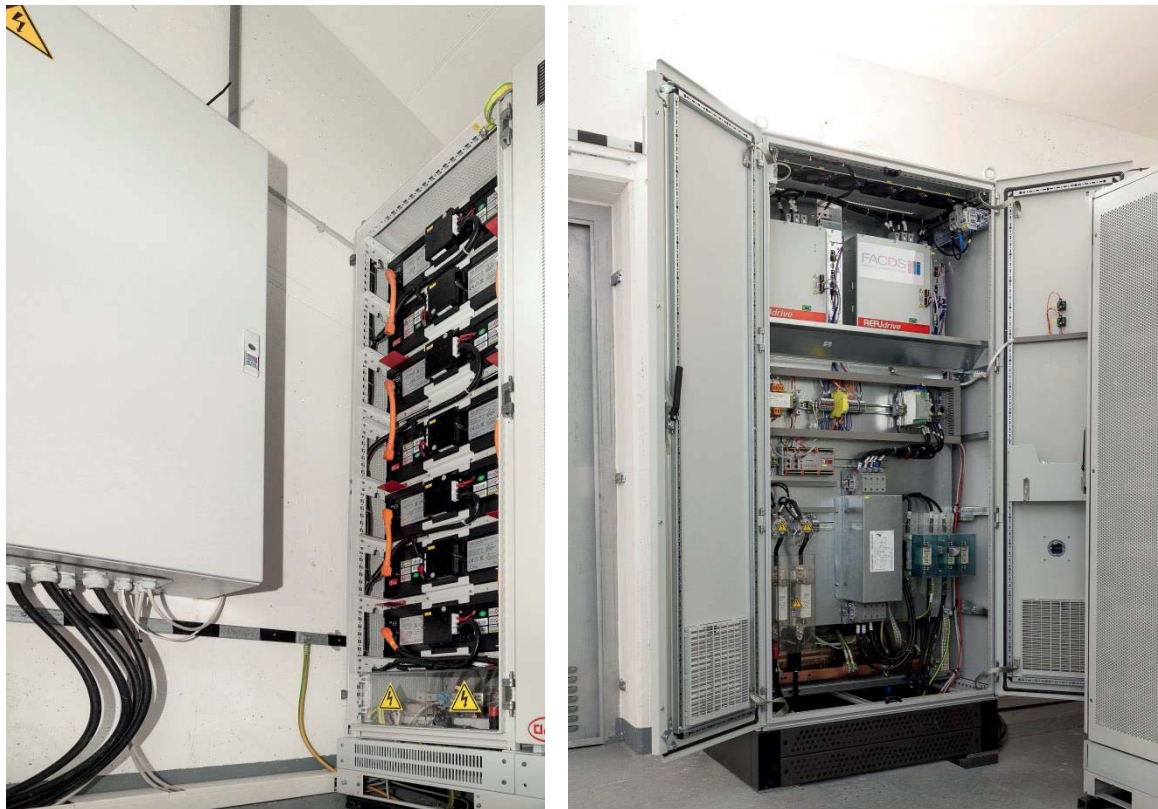
Abbildung 2: Batteriesystem (links) und Umrichtersystem (rechts)
