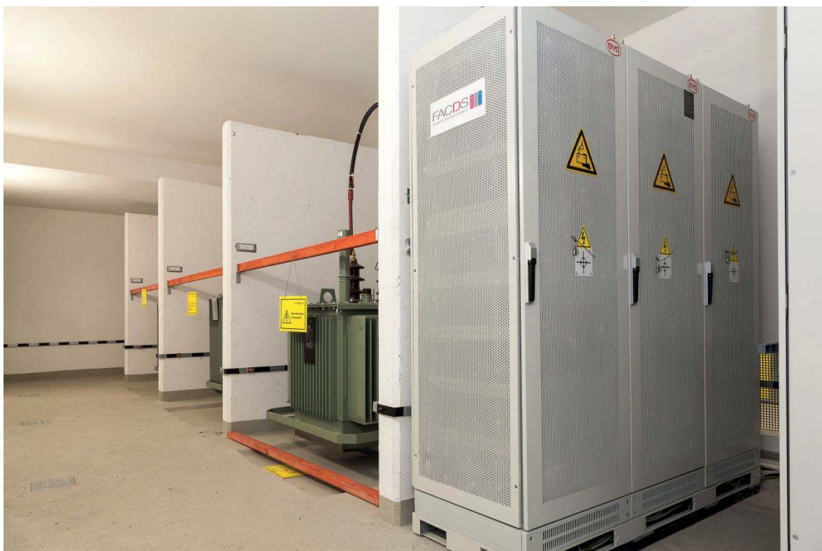
Abbildung 3: Batteriesystem in der Trafokoje
