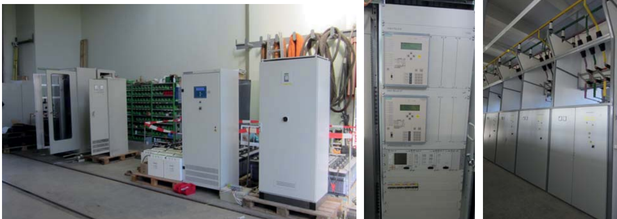
Abbildung 2) UW Versuchsaufbau in der Kranhalle des UW Landskron (links), beim Versuch verwendete Primär- und Sekundärtechnik des bestehenden UW Landskron (mitte und rechts)
