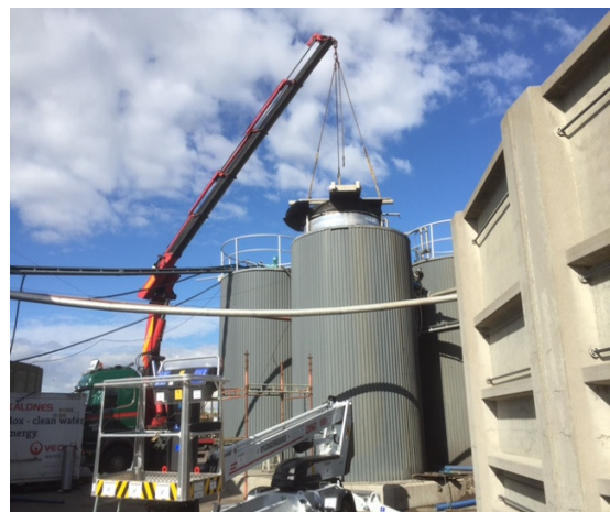
Abbildung 3: Installation der Anammoxreaktoren auf einer 550.000 EW Anlage in Schweden zur Hauptstrombehandlung (Quelle: Veolia Water Technology)
