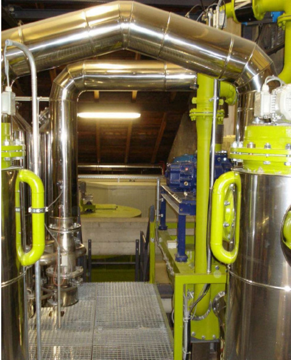
Abb. 4: Ansicht B des Biomasseheizkraftwerkes (Teilkomponenten der Gasreinigung)
