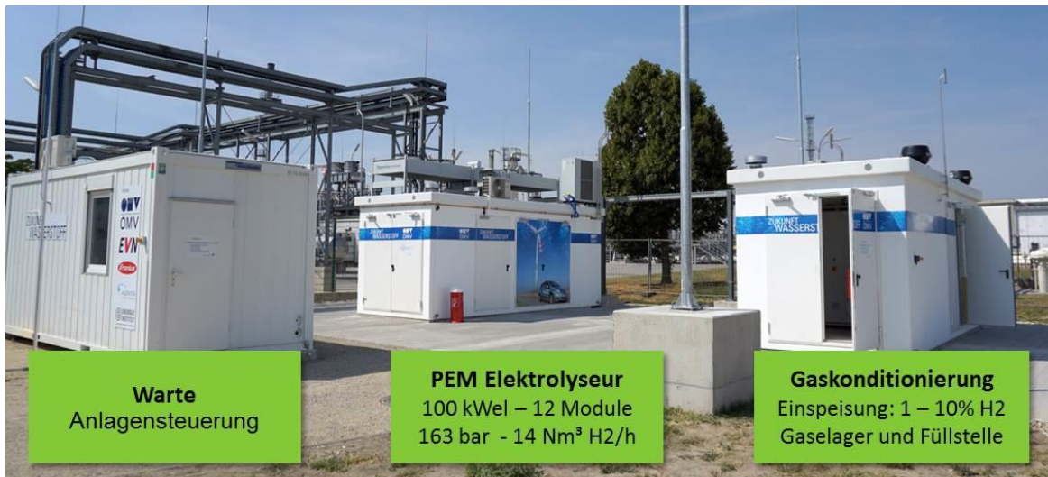
Abbildung 1: Anlage mit Warte, PEM Elektrolyseur und Gaskonditionierung.
