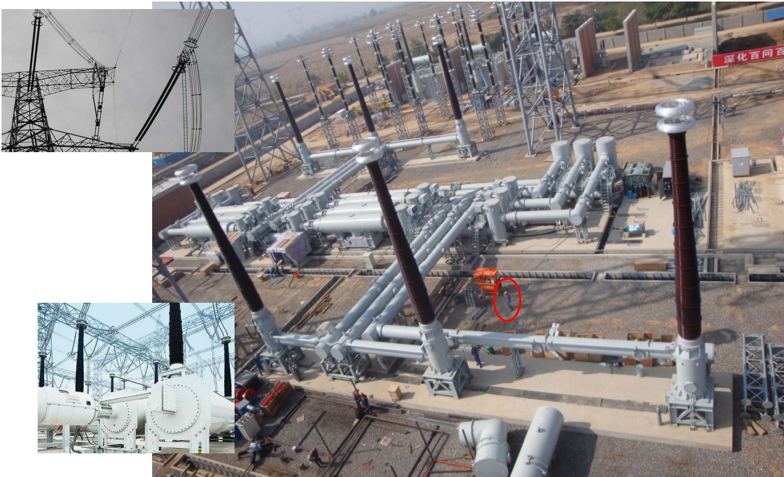
1100 kV Jin Dong Nan Substation, China (seit 2009 in Betrieb)
