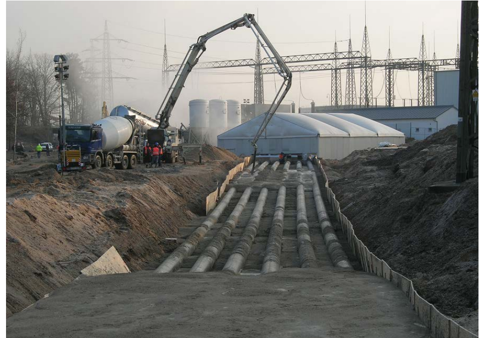
GIL Kelsterbach, Frankfurt/Main 380 kV, 2750 A, 950 m, erdverlegt, 2011 N 2 /SF 6 -Mischgas: 80% / 20%
