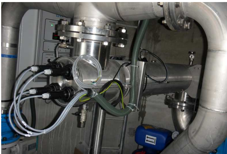
Bild 2: UV-Anlage im Brunnen Dobersdorf
