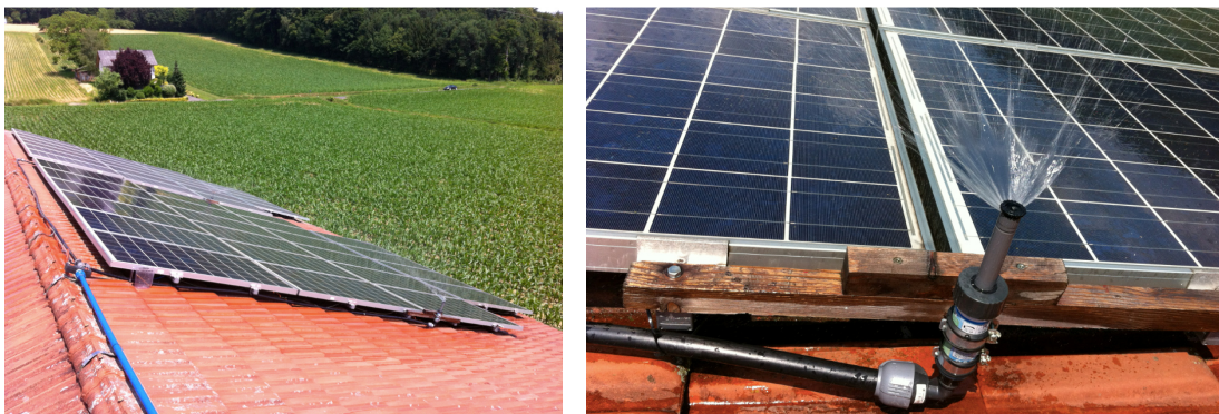
Abbildung 1 Ansicht beider Anlagen im Kühlbetrieb (links), Detailansicht einer Sprühdüse im Kühlbetrieb (rechts)
