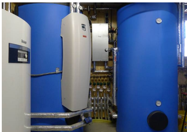
Abbildung 20: insgesamt stehen 2.500 l Speicher für Solarthermie, für Brauchwasser und Raumheizung zur Verfügung
