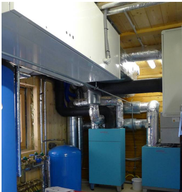
Abbildung 15: Technikraum mit den 3 Lüftungsgeräten
