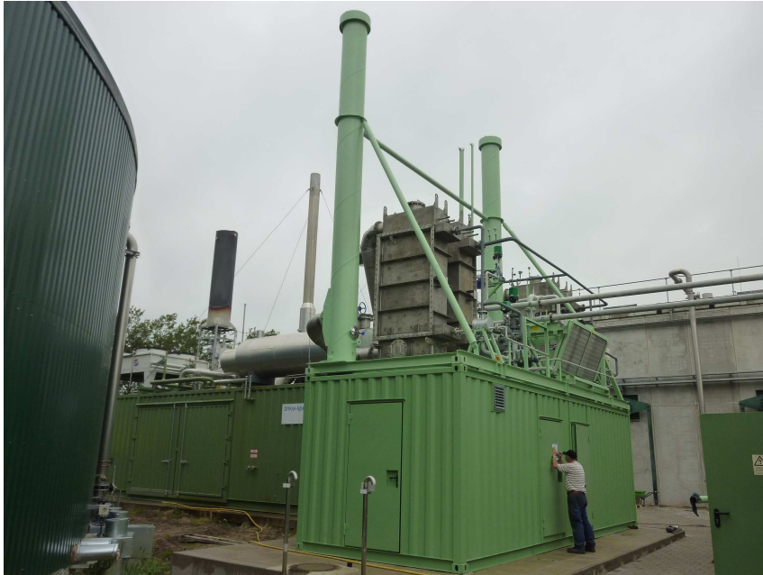
Abb. 7 Bild der ORC-Anlage Kirchwalsede
