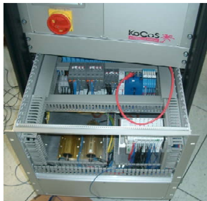
Einschub für Netzschutzprüfungen
