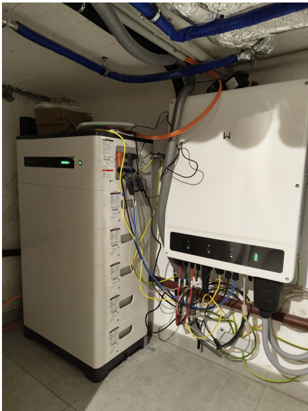
Batterie und Wechselrichter
