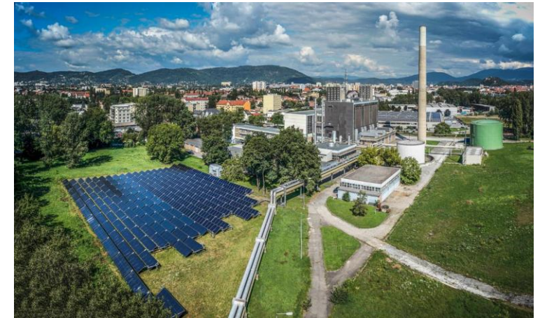
Quelle: S.O.L.I.D (AEVG-Fernheizwerk Graz)
