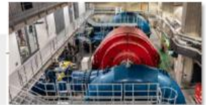
Reißeck II+ VERBUND 45 MW T/P In Betrieb; IBN: 2025
