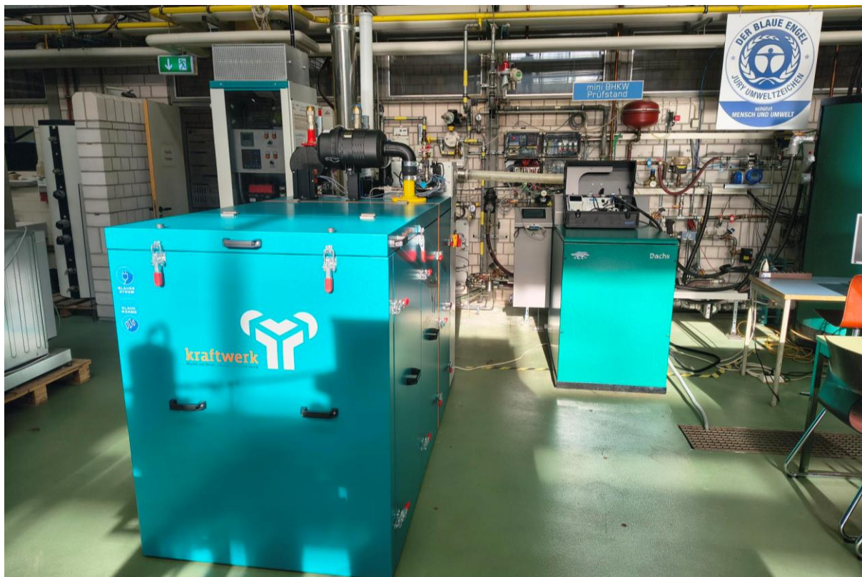
Abbildung 2: BHKW-Prüfstand mit dem Mephisto G50H (links) und dem auf Wasserstoff umgerüsteten Dachs Gen 2 G5.5 (rechts)
