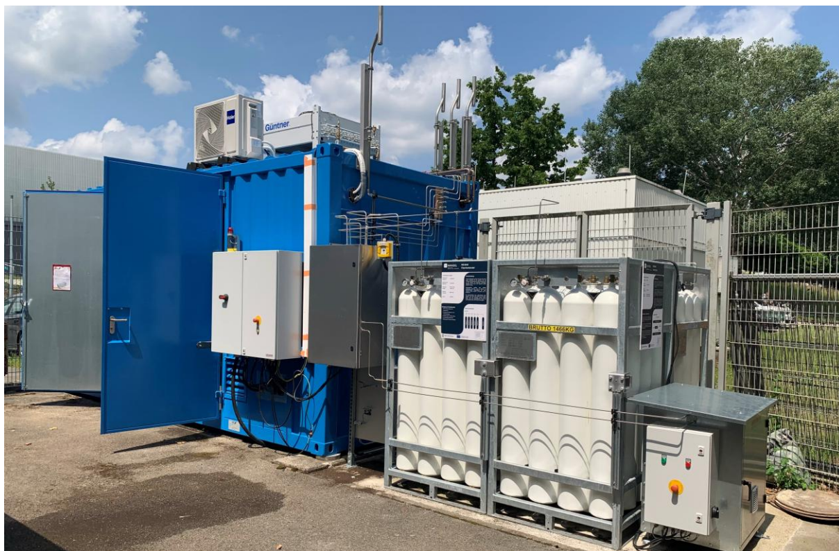
Abbildung 1: Überseecontainer mit AEM- und PEM-Elektrolyse, sowie PEM-Brennstoffzelle. Rechts davon sind die vier Speicherbündel sowie der Kompressor zu sehen.
