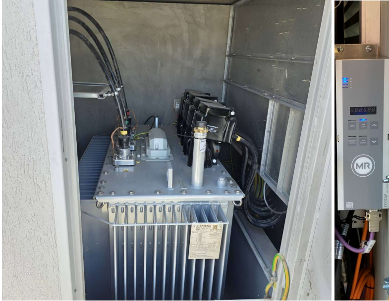
Abbildung 4: Installierter Verteilnetztransformator mit MR Stufenschalter und Steuereinheit
